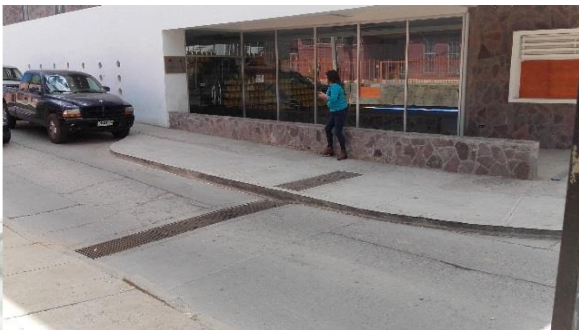
Imagen. Evacuación de aguas lluvia.
